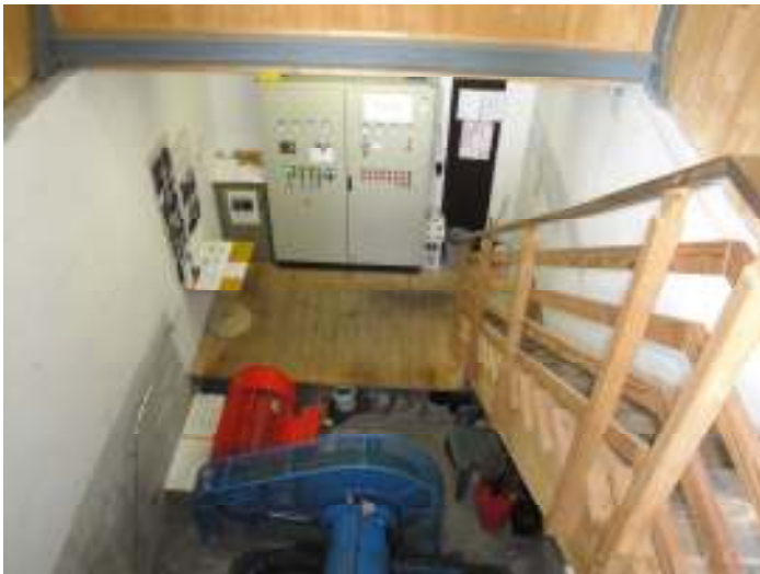
Blick ins Kleinwasserkraftwerk an der Sure
